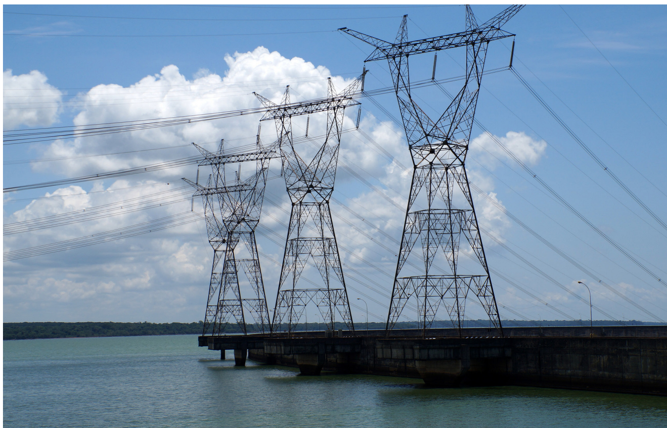
As linhas de transmissão permitem o controle centralizado, otimizando a geração e a distribuição de energia no país
